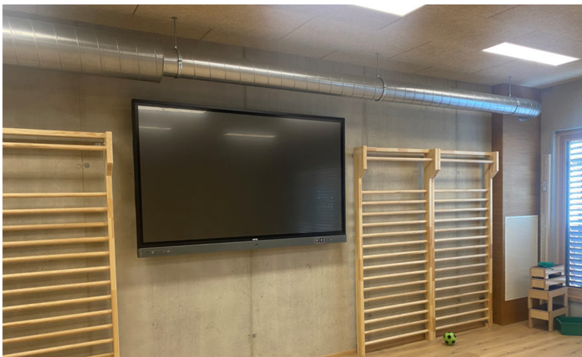
Abbildung 12: Quellluftauslässe beim Fenster
