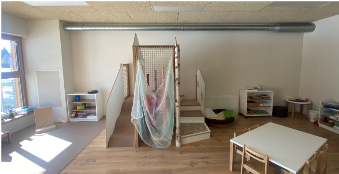
Abbildung 11: Quellluftauslässe beim Fenster
