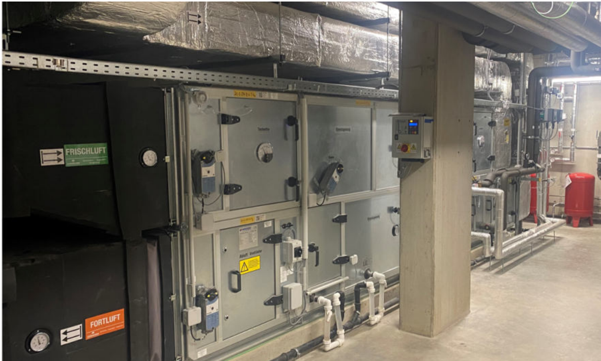
Abbildung 4: Lüftungszentrale im UG
