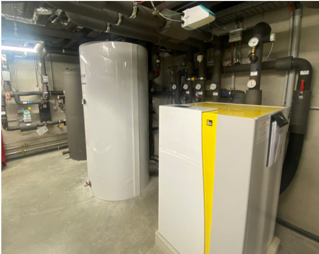
Abbildung 13: Erdreich-Wärmepumpe für Heizung und Kühlung
